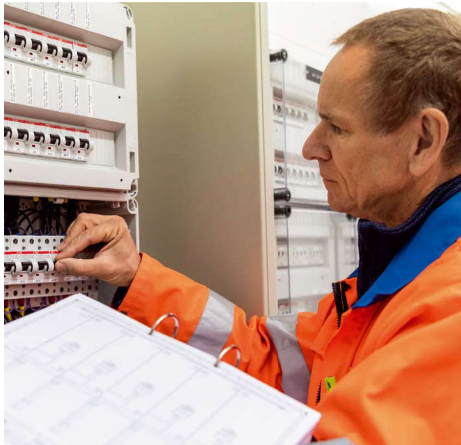
Walter Schrödel von M-T-N setzt als Projektleiter auf Technik von ABB.
