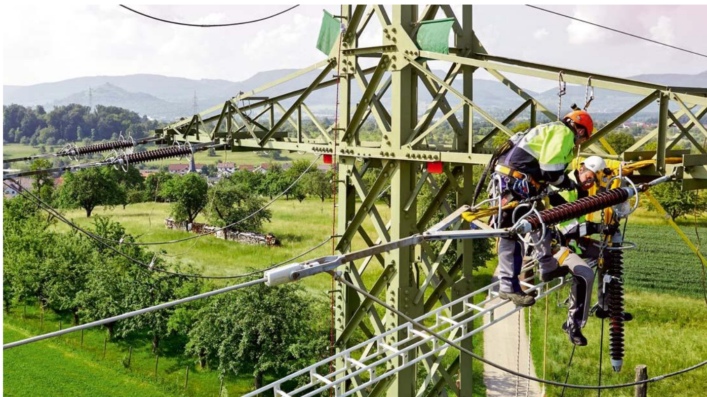
Die Netze BW baut ihre Verteilnetze kontinuierlich aus, wobei die Netzanbindung von erneuerbaren Energien eine besondere Rolle spielt.
